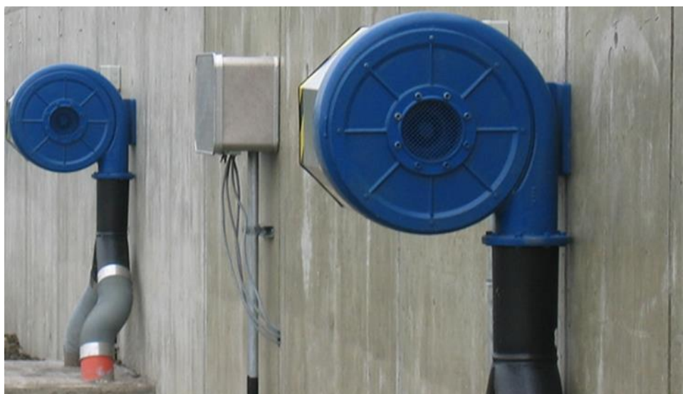
Figura 23: Ventiladores del sistema de aireación adheridos a la pared posterior de camas de maduración.
