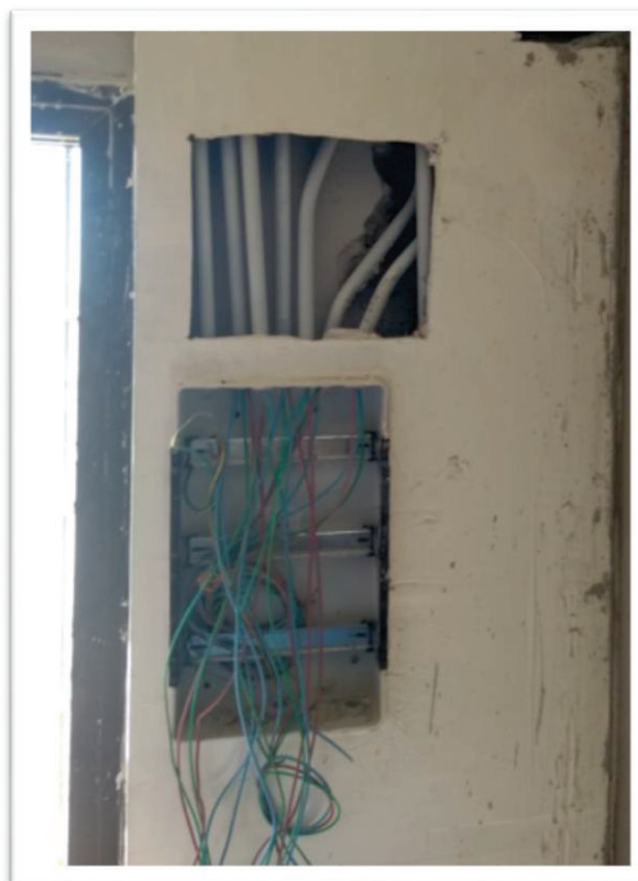
Ilustración 22 Cableado de tablero general
