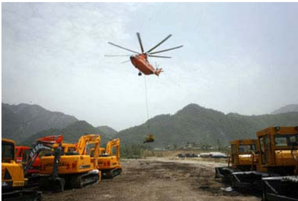
Fot. n ° 12.08.- El equipo de construcción para la excavación del canal fue transportado al lugar de trabajo por un helicóptero militar (capacidad de 12 t) y retirado en parte con el mismo medio.
