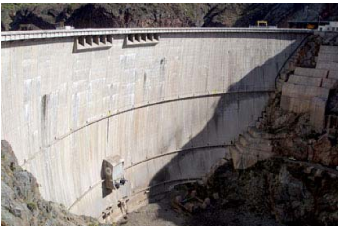
Fot. nº 5.04.- Presa Agua del Toro, tipo arco doble curvatura (río Diamante, Mendoza) ( extraída de Rodríguez, Fernández y Gutiérrez, 2009 )
