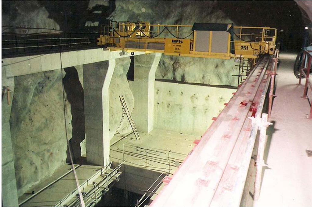
Foto. N° 12.03.- Estructura de hormigón armado para el puente grúa de montaje y mantenimiento de los órganos de control del descargador de fondo.
