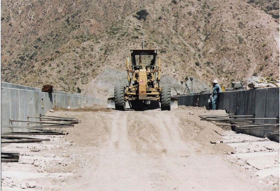
Fot. nº 14.2.- Presa Potrerillos.. Relleno parcial entre los elementos prefabricados del coronamiento.
