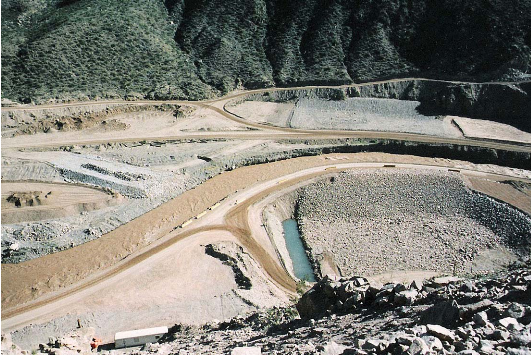
Fot. n° 11.09.- Sectores extremos de la fundación del ataguía para desvío total del río.(Etapa 1, desvío parcial del río, diciembre/1999)
