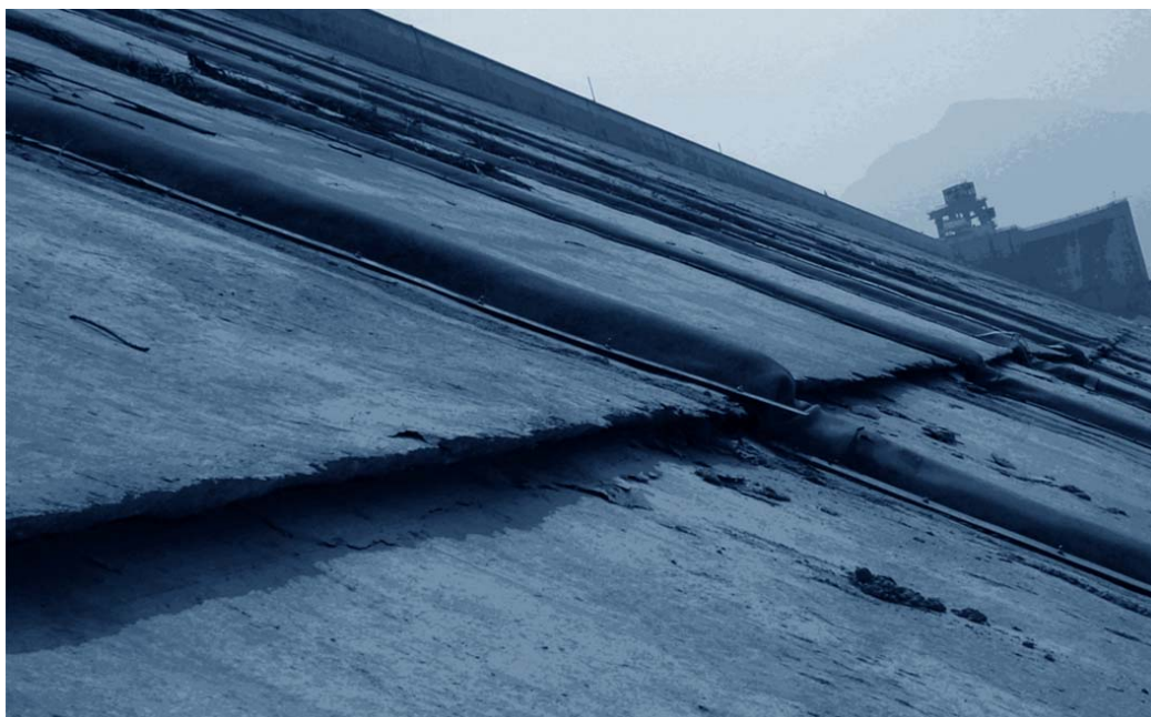
Foto nº 6.05.- Presa Zipingpu. Rotura por la junta de construcción (entre segunda y tercer etapa de hormigonado, a cota 845 ). Ha quedado un desplazamiento relativo entre ellas que afecta a las barras de la armadura pasante. (Zeping Xu, 2009)
