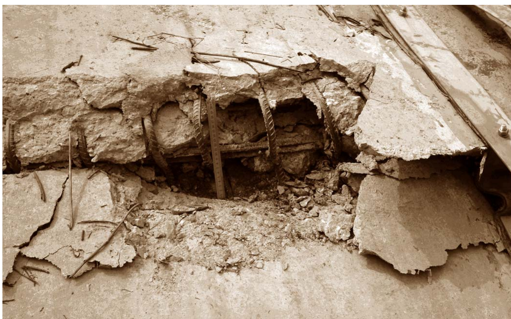
Fot. nº 6.06.- Presa Zipingpu.- Grieta horizontal por la junta de construcción de la pantalla. Barras dobladas en Z. (de Zeping Xu, 2009)
