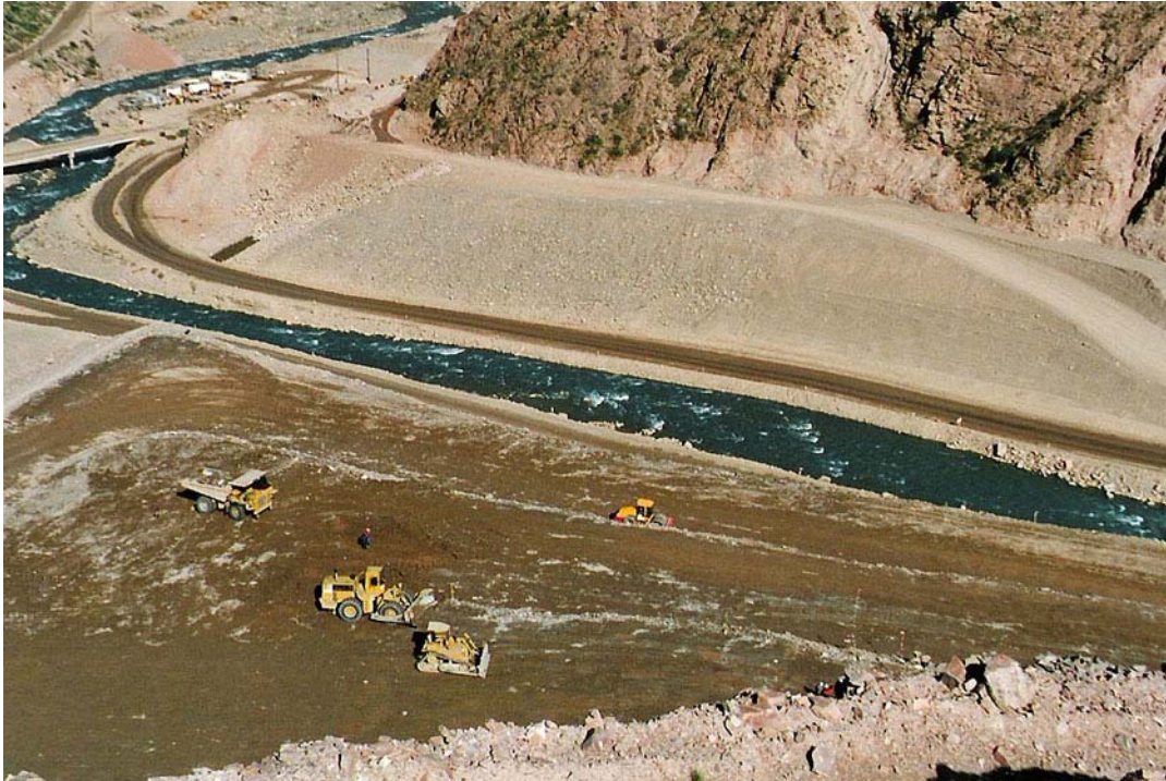
Foto. N° 11.01.- Presa Potrerillos. Etapa 1 del desvío de río. Preparación de fundaciones del cuerpo de la presa en su estribo de margen derecha. (Octubre. 2000)
