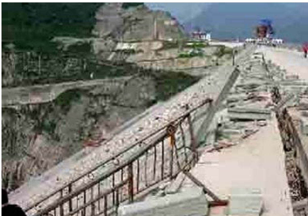
Fot. nº 6.04.- Presa Zipingpu. Rotura de baranda en el coronamiento y desplazamiento horizontal del veredín de aguas abajo de la calzada de hormigón..
