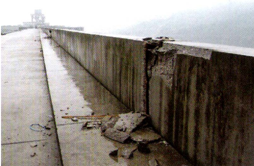
Foto nº 6.03.- Parapeto en el coronamiento de la presa Zipingpu (China). Terremoto del 12/05/2008. Roturas por compresión en correspondencia de juntas muy separadas. entre sí ( bajada de Internet )
