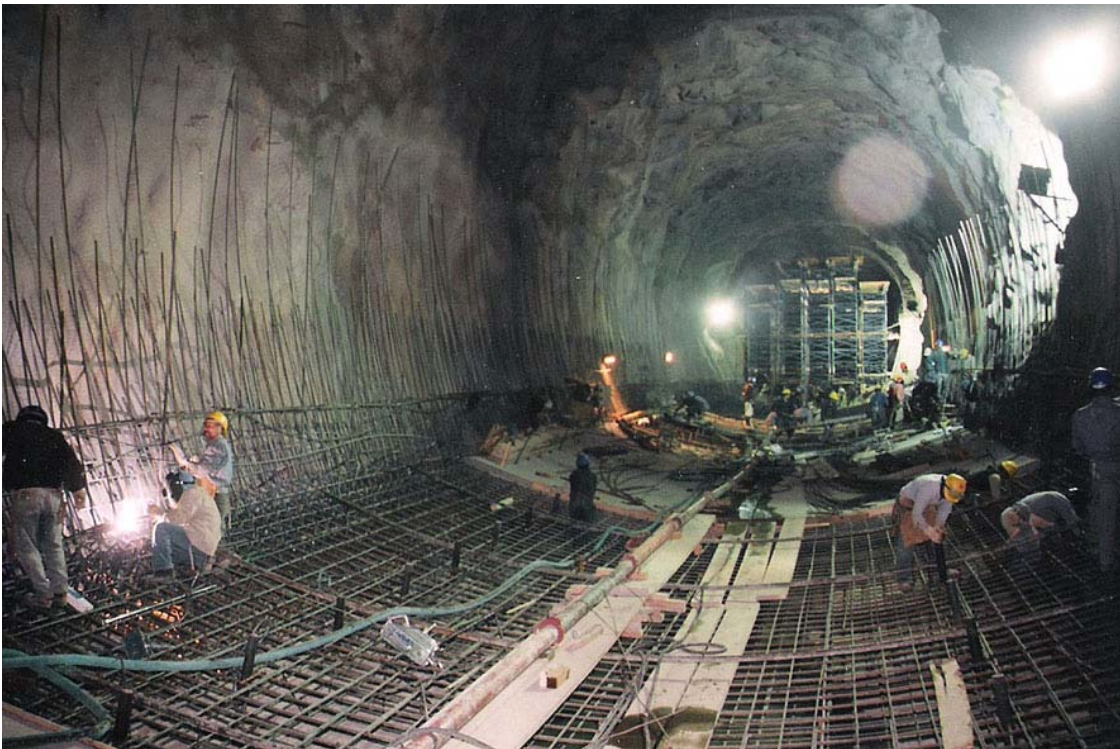
Fot. nº 11.06.- Tunnel del desvío del río. Construcción sucesiva de armadura y hormigonado de solera y bóveda.
