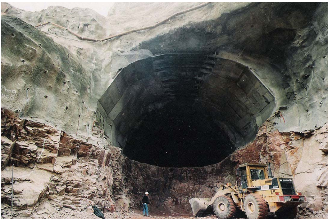
Fot. nº 9.05.- Aliviadero Potrerillos. Excavación por banqueo para completar la sección bruta del túnel
