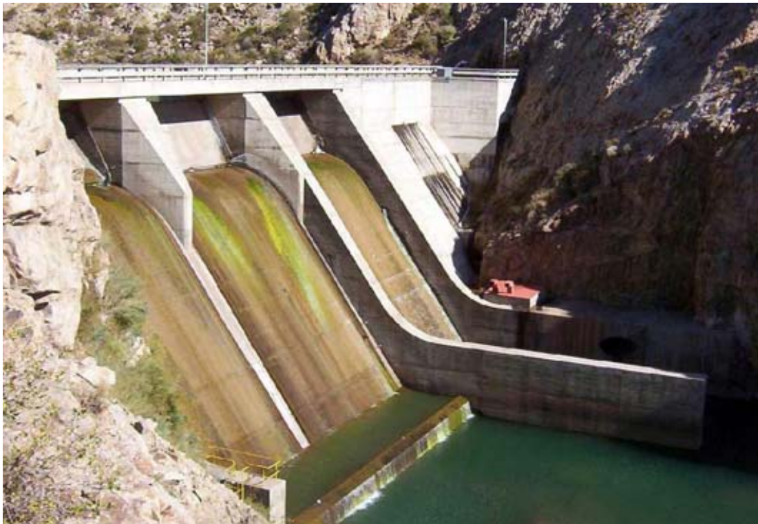
Fot. n° 3.02.- Presa Aisol, tipo gravedad planta recta (río Atuel) (de Rodríguez, Fernández y Gutiérrez, 2009)
