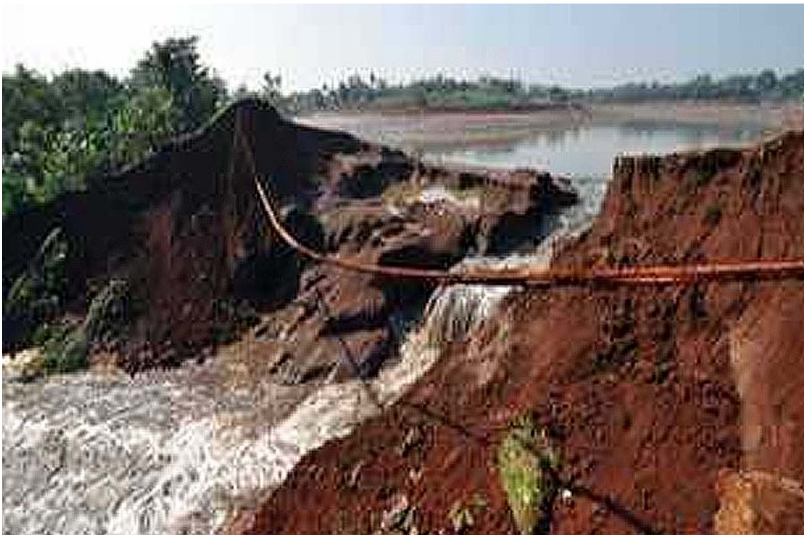
Fot. n° 2.04.- Presa Lago Gintung (Indonesia). Rotura por sifonaje, el 28 de marzo del 2009. Presa de tierra de material homogéneo ( bajada de Internet )
