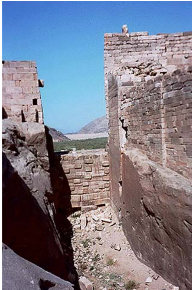
Fot. nº 2.08.- Presa Marib. Aliviadero. No fue suficiente para evitar el sobrepaso, que erosionó la parte central de materiales sueltos. ( bajada de Internet )
