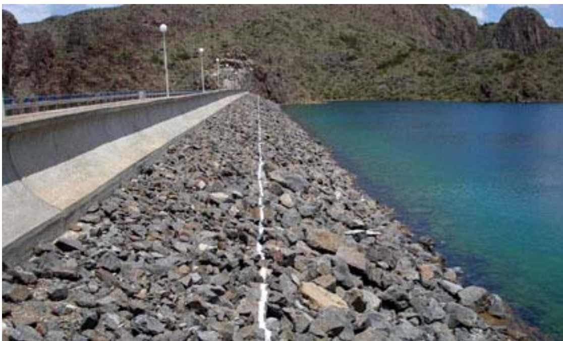
Fot. nº 5.03.- Presa Los Reyunos, tipo materiales sueltos (río Diamante, Mendoza). Línea para auscultación visual. ( de Rodríguez, Fernández y Gutiérrez, 2009 )
