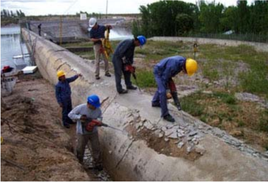
Fot. nº 12.09.-Presa El Nihuil. Reparación del vertedero. Hormigón afectado por la reacción alcali-agregados .( bajado de Internet )
