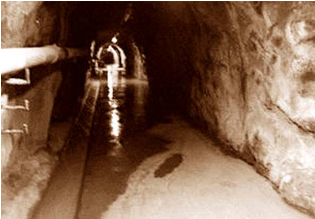
Fot. nº 12.10.- Presa Potrerillos. Galería de acceso a caverna del descargador de fondo. La cuneta conduce el agua al exterior, luego de haber pasado por la sección de aforo.
