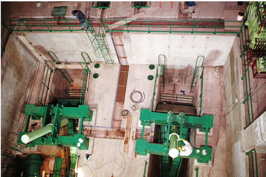
Fot. n° 12.04.- Caverna del descargador de fondo de la presa Potrerillos. Vista externa de las compuertas radiales montadas.
