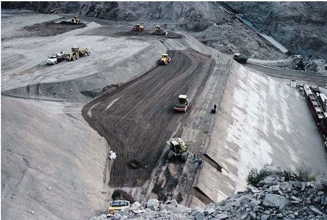
Fot. nº 11.12.- Desvío total del río permite ir construyendo la totalidad del cuerpo de la presa. Vista hacia margen derecha donde está dispuesta una rampa de acceso para el transporte de materiales (Septiembre/2000).
